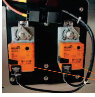
Servomoteurs air primaire / secondaire
